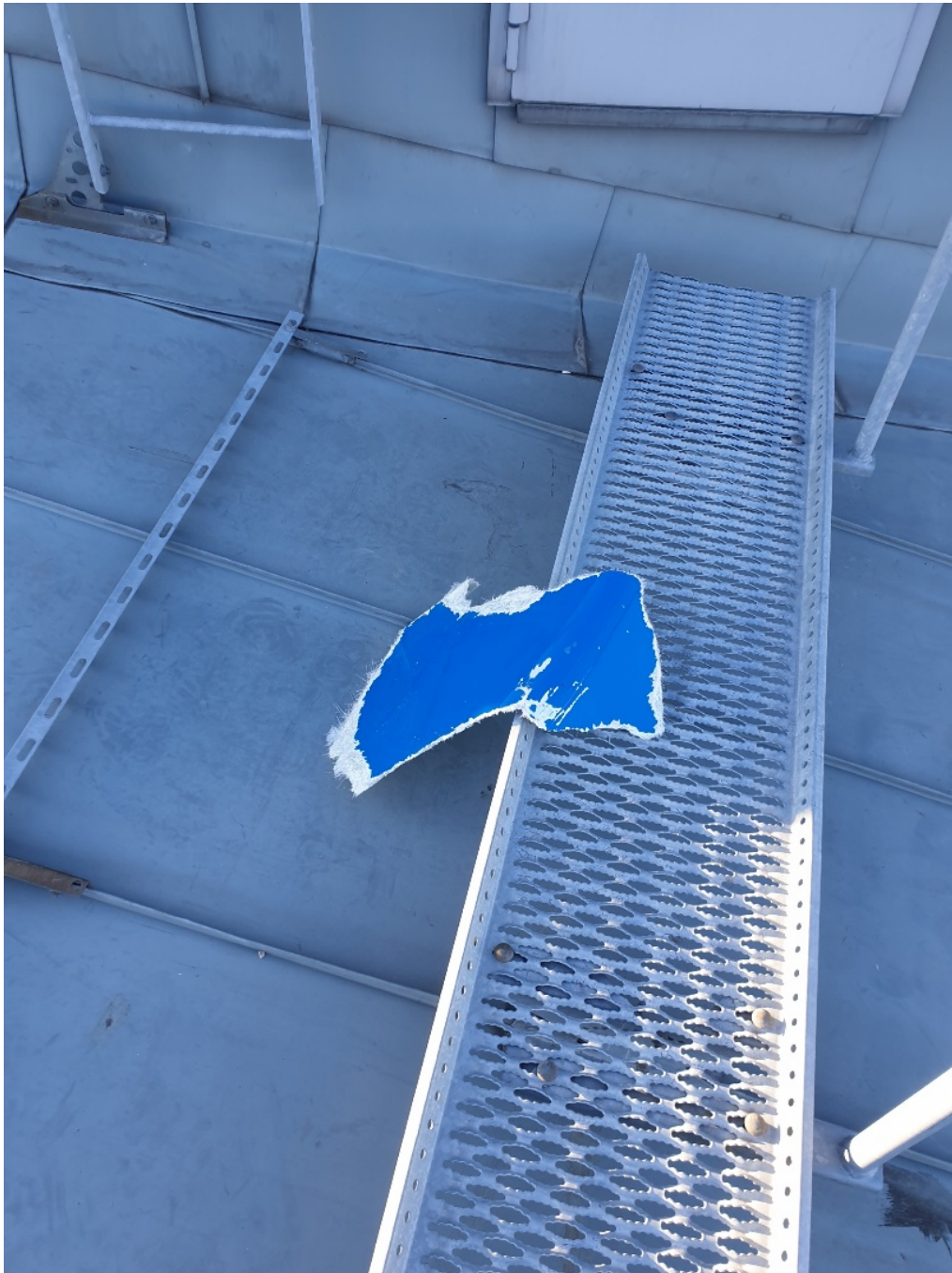
Foto 16: En bit av kåpan ovanför gasflaskorna hittas på taket på byggnaden ovan Klaratunnelns infart.
