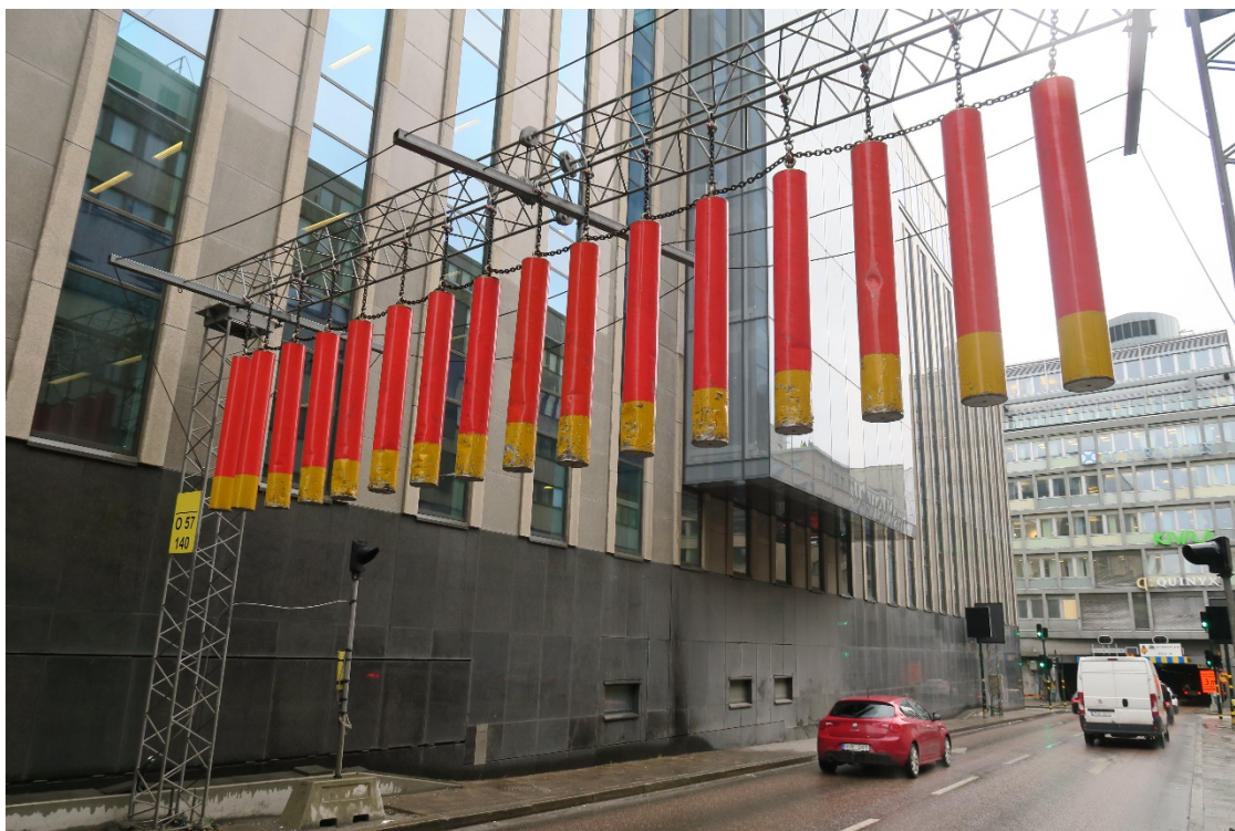
Foto 11: Skador på de hängande rören visar på att de blivit påkörda många gånger.
